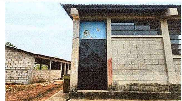
Foto 6: Puerta de bodega en mal estado
