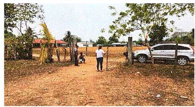
Foto 4: Porton del establecimiento en mal estado
